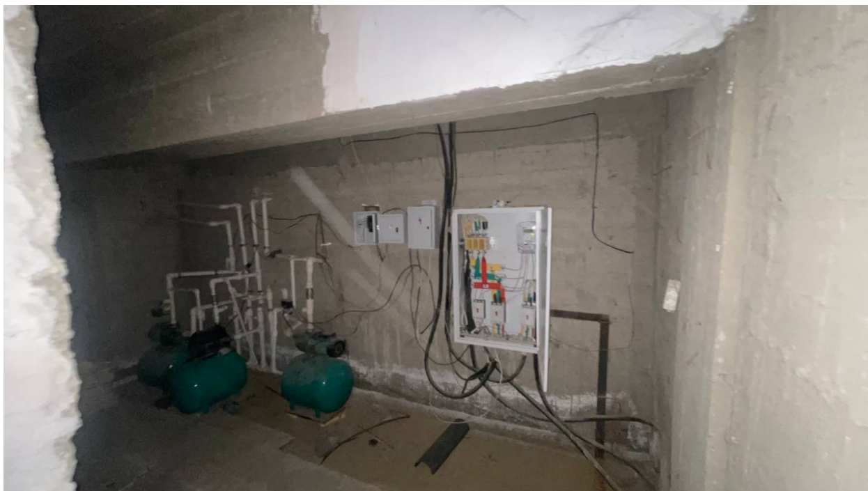
Фото 4. Общий вид монолитной железобетонной стены цокольного этажа блока Д по оси Б в осях 6-7. На стене не выполнена торкрет штукатурка что противоречит проекту по разработанному усилению
