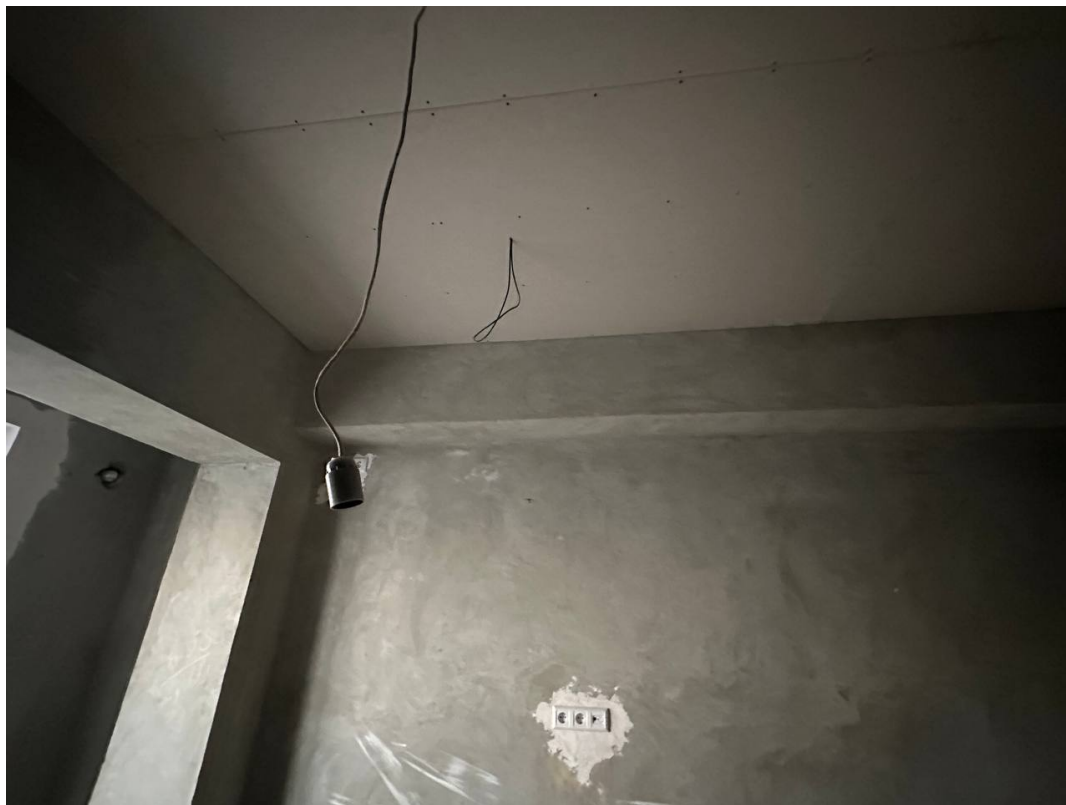
Фото 35. Фрагмент одного из помещений 5-го этажа. Отсутствуют усиления ригеля что противоречит проекту по разработанному усилению.
