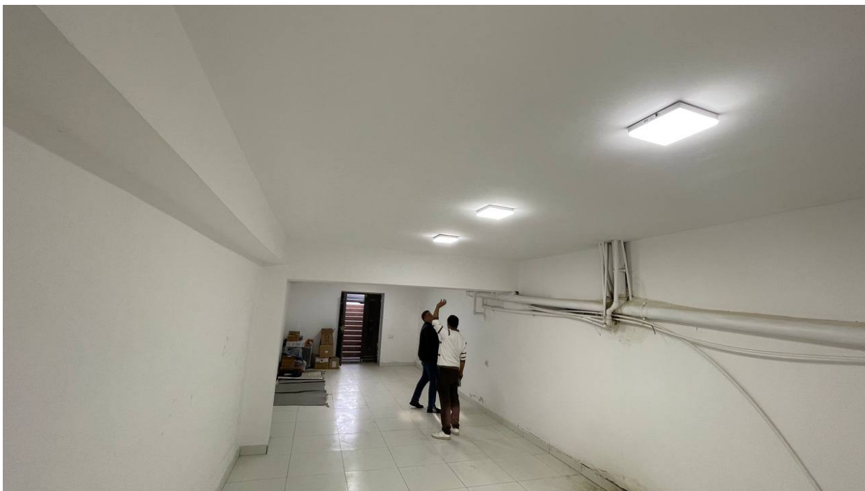
Фото 17. Фрагмент одного из помещений цокольного этажа. Отсутствует торкрет штукатурка стен что противоречит проекту по разработанному усилению.
