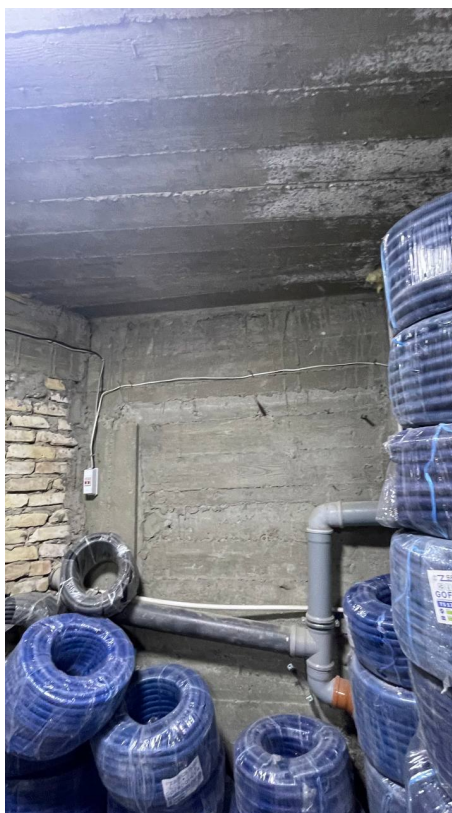
Фото 22. Фрагмент одного из складских помещений цокольного этажа. Отсутствует торкрет штукатурка стен что противоречит проекту по разработанному усилению.
