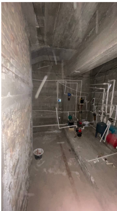
Фото 7. Фрагмент монолитной железобетонной стены цокольного этажа блока Д по оси 3 в осях Б-Г. На стене не выполнена торкрет штукатурка что противоречит проекту по разработанному усилению
