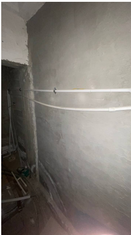
Фото 9. Фрагмент монолитной железобетонной стены цокольного этажа блока Д по оси 4 в осях В-Г. На стене не выполнена торкрет штукатурка что противоречит проекту по разработанному усилению
