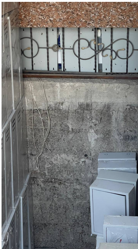
Фото 23. Фрагмент монолитной железобетонной стены цокольного этажа. Отсутствует торкрет штукатурка стены что противоречит проекту по разработанному усилению.
