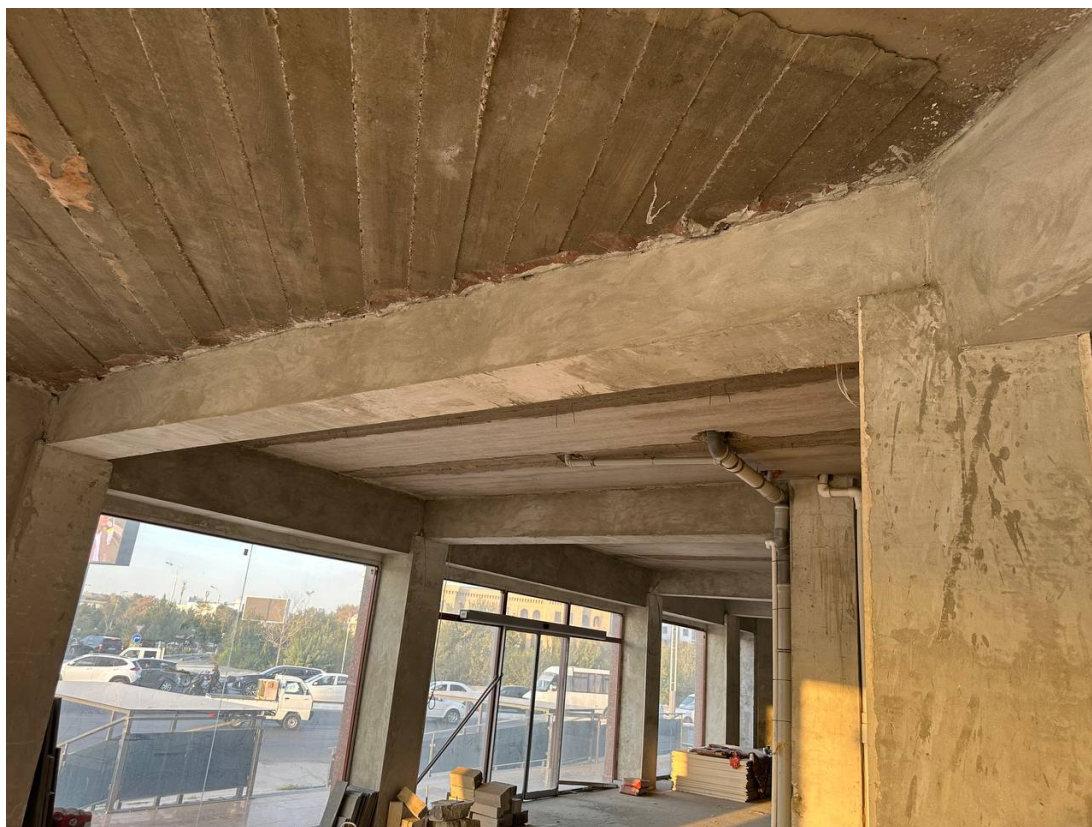
Фото 27. Фрагмент одного из помещений 1-го этажа. Отсутствуют усиления ригеля что противоречит проекту по разработанному усилению.
