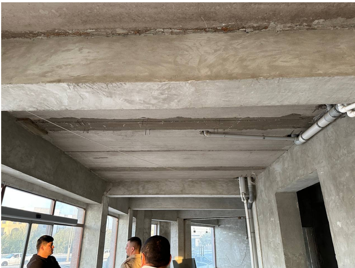
Фото 29. Фрагмент одного из помещений 1-го этажа. Отсутствуют усиления ригеля что противоречит проекту по разработанному усилению.
