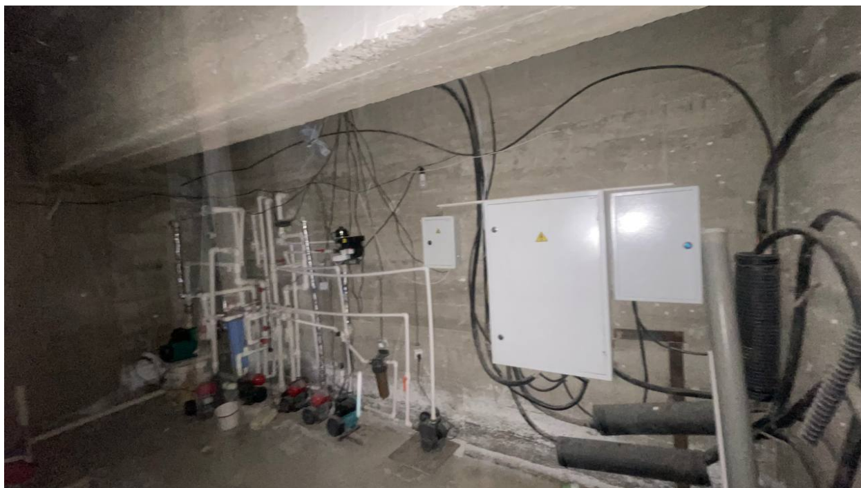
Фото 6. Общий вид монолитной железобетонной стены цокольного этажа блока Г по оси Б в осях 3-4. На стене не выполнена торкрет штукатурка что противоречит проекту по разработанному усилению
