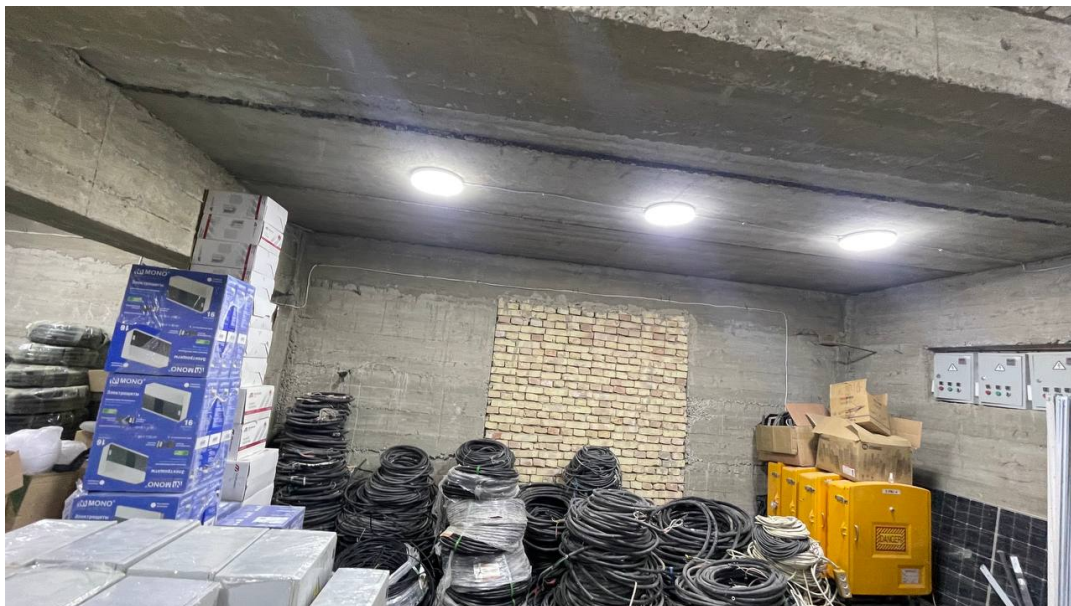
Фото 21. Фрагмент одного из складских помещений цокольного этажа. Отсутствует торкрет штукатурка стен что противоречит проекту по разработанному усилению.
