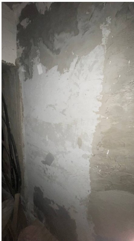
Фото 5. Фрагмент монолитной железобетонной стены цокольного этажа блока Д по оси 7 в осях В-Г. На стене не выполнена торкрет штукатурка что противоречит проекту по разработанному усилению
