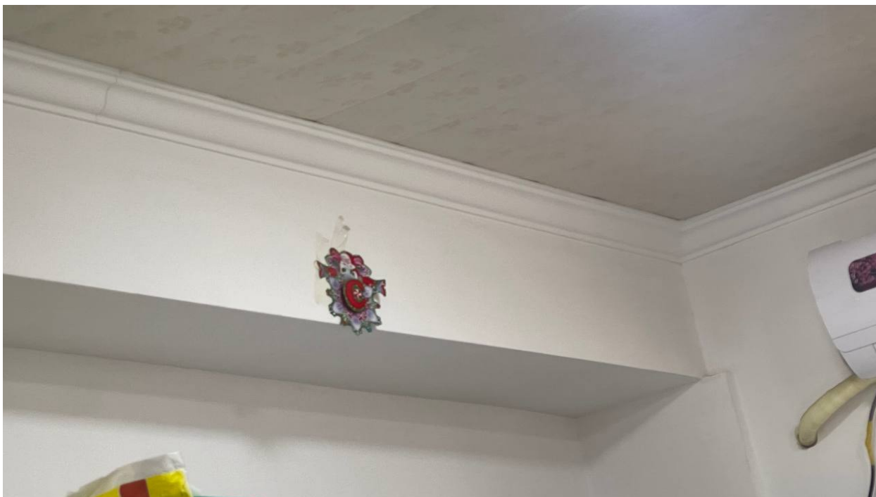
Фото 13. На фрагменте монолитного железобетонного ригеля блока Д по оси 8 в осях В - Г отсутствует усиление разработанное проектом
