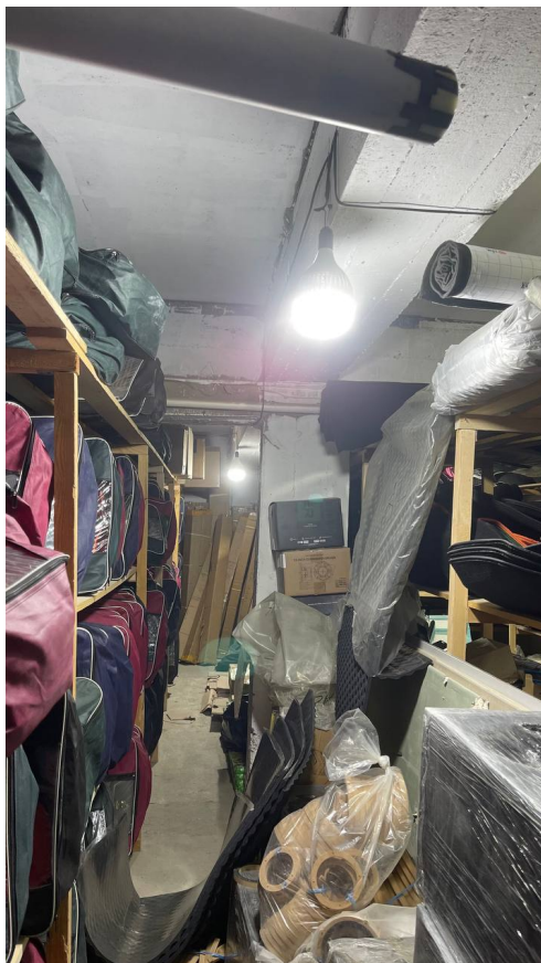
Фото 37. Фрагмент одного из складских помещений цокольного этажа. Отсутствует торкрет штукатурка стен, а также отсутствуют усиления ригеля что противоречит проекту по разработанному усилению.
