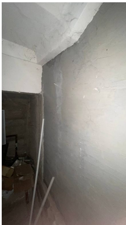
Фото 12. Фрагмент монолитной железобетонной стены цокольного этажа блока В по оси 21 в осях В-Г. На стене не выполнена торкрет штукатурка что противоречит проекту по разработанному усилению
