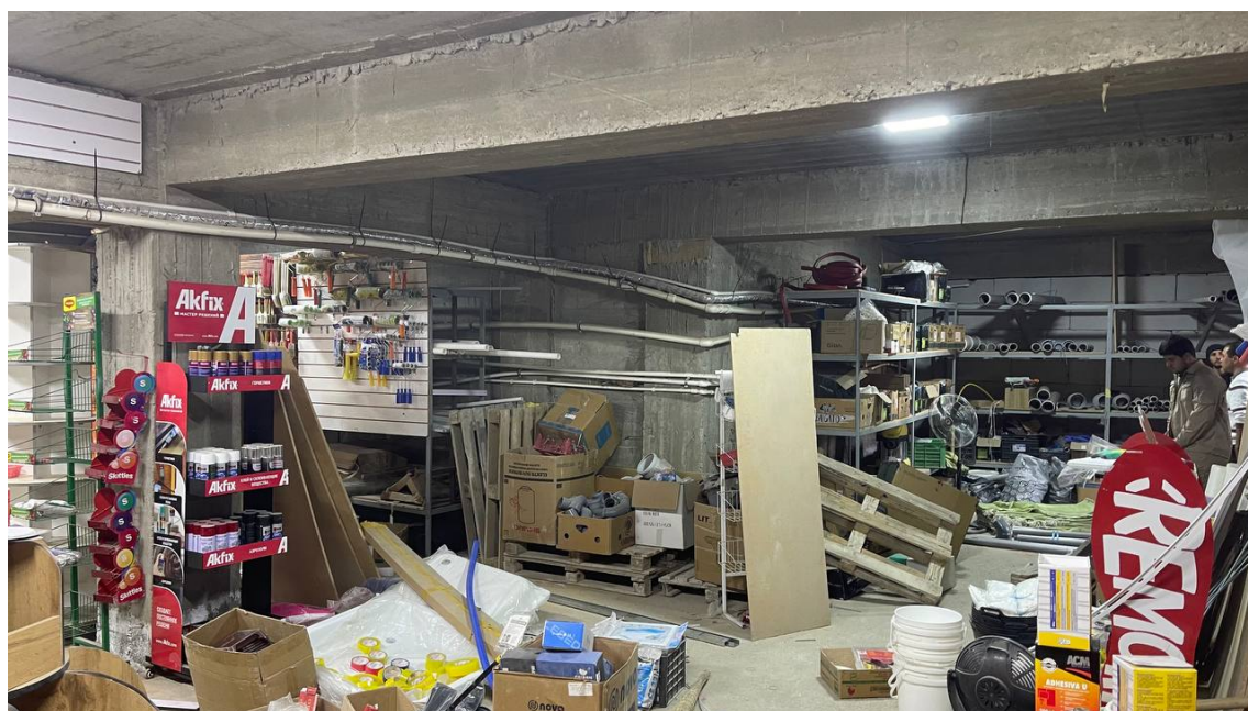
Фото 28. Фрагмент одного из помещений цокольного этажа. Отсутствует торкрет штукатурка монолитных железобетонных стен что противоречит проекту по разработанному усилению.
