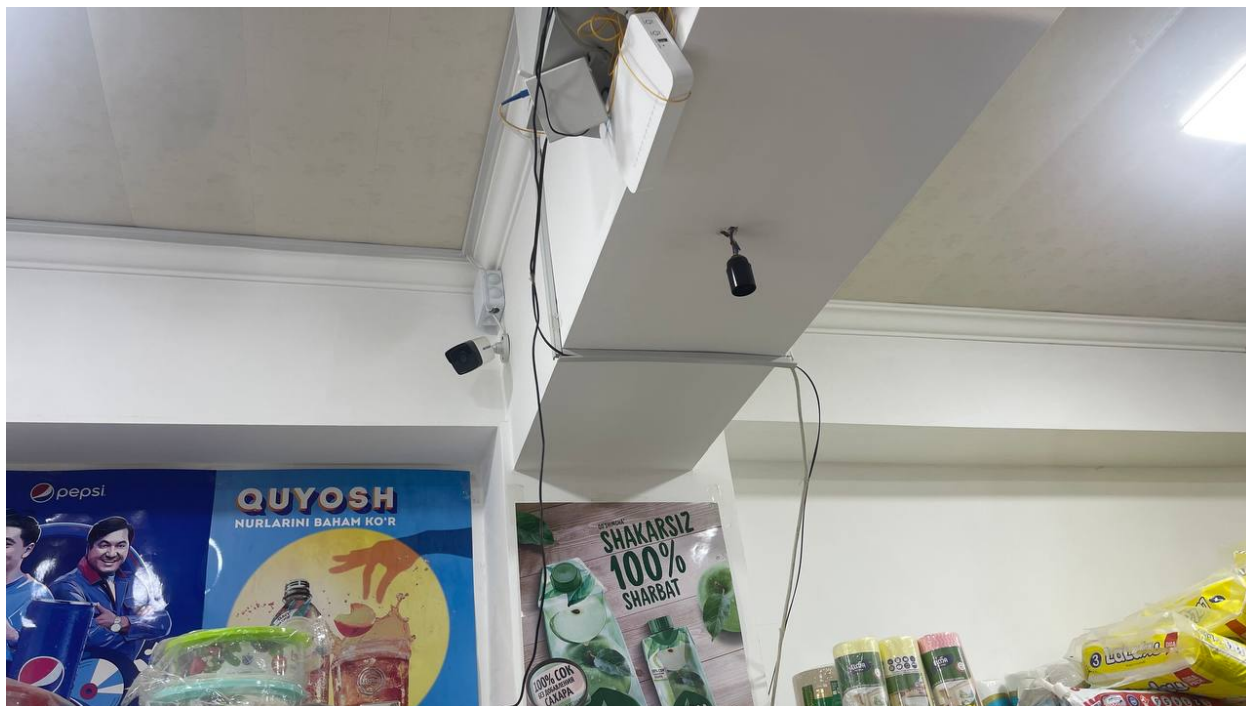
Фото 11. На фрагменте монолитного железобетонного ригеля блока Д по оси 8 в осях Б-В отсутствует усиление разработанное проектом
