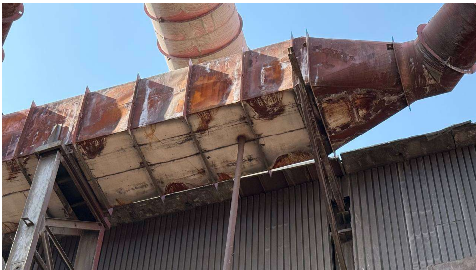
57-rasm. Gazoxod trubasining pastki qismi va tayanch konstruksiyasi (korroziyaga uchragan holat)
