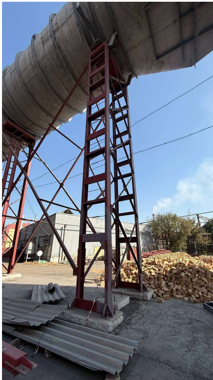
20-rasm. Gazoxod trubasini ushlab turuvchi tashqi tayanch ustunlar (stoykalar) metall konstruksiyalar holati.
