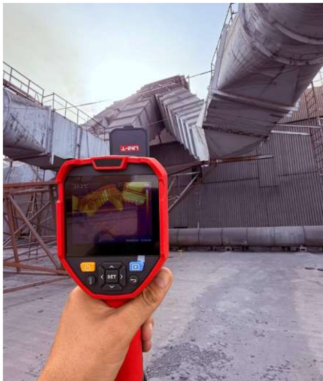
39-rasm. Gazoxod trubasining egilgan qismi termovizor yordamida tekshirilishi
