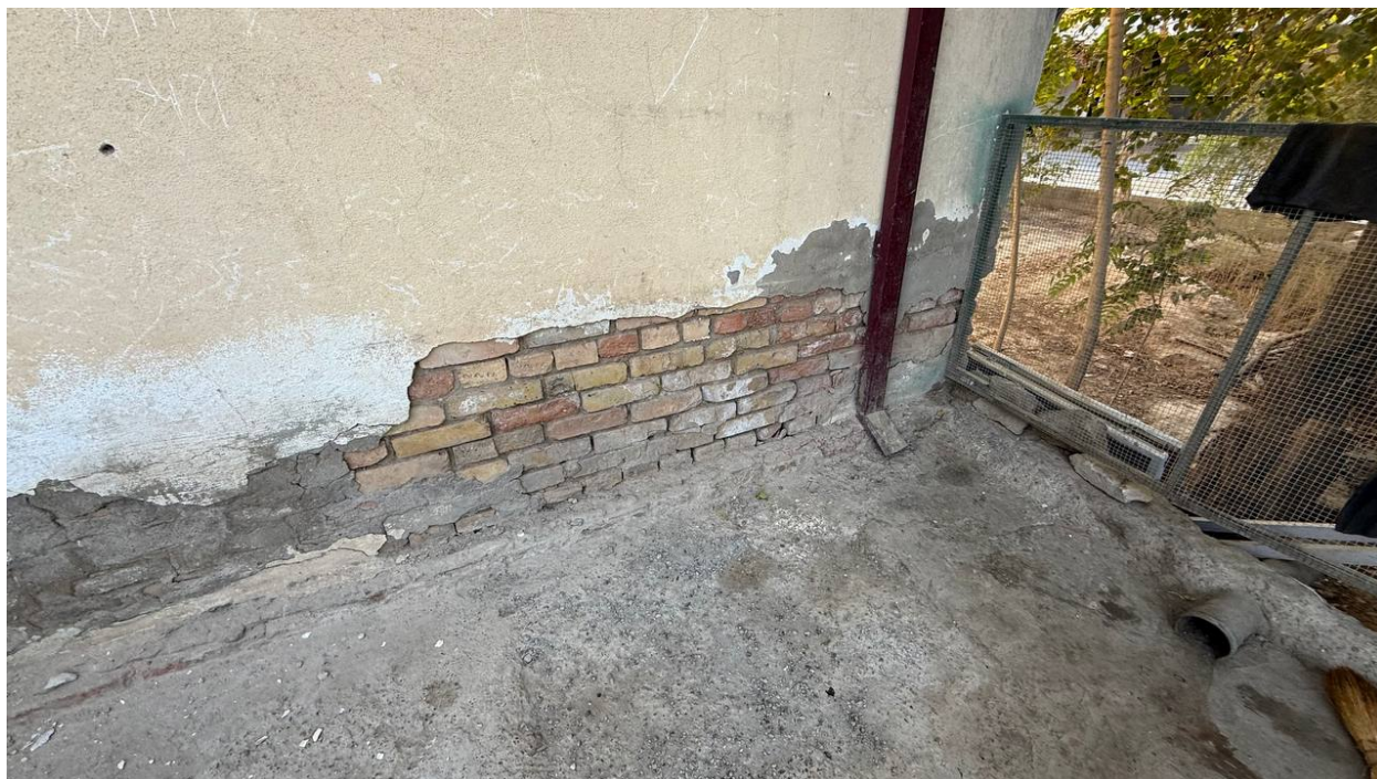
Фото 5. Цокольная часть и отмостка здания поврежденные; деформация стен и штукатурного слоя.
