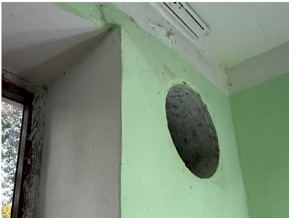
Фото 3. Фрагмент дымохода, рекомендуется канал дымохода заполнить и до уровня стены и произвести штукатурку.
