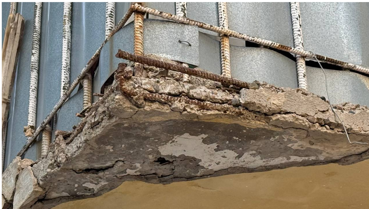
Фото 5. Фрагмент балкона жилого дом; в конструкции наблюдаются существенные трещины и коррозии.
