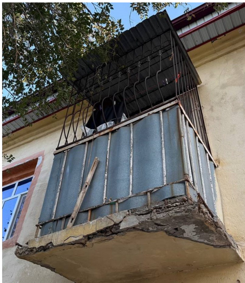
Фото 4. Общий вид балкона жилого дом; в конструкции наблюдаются существенные трещины и коррозии.
