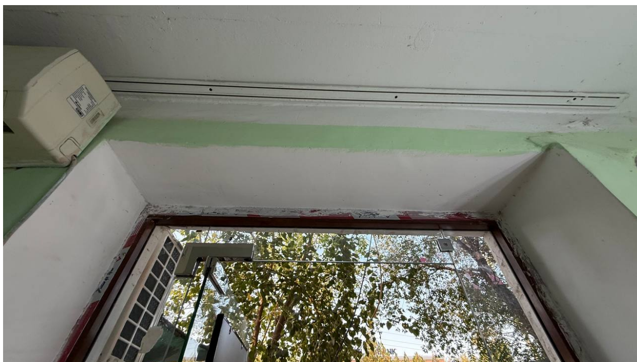
Фото 2. Фрагмент перемычки входной двери, состояние удовлетворительная.
